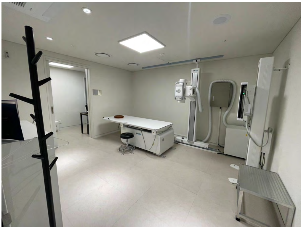
Xray / C-Arm檢測室 天花、地坪、牆面及門板皆須設置鉛板
